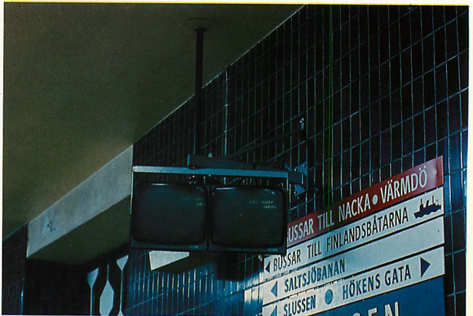
TV-monitor för enmansbetjänade tunnelvagnståg. Slussen
