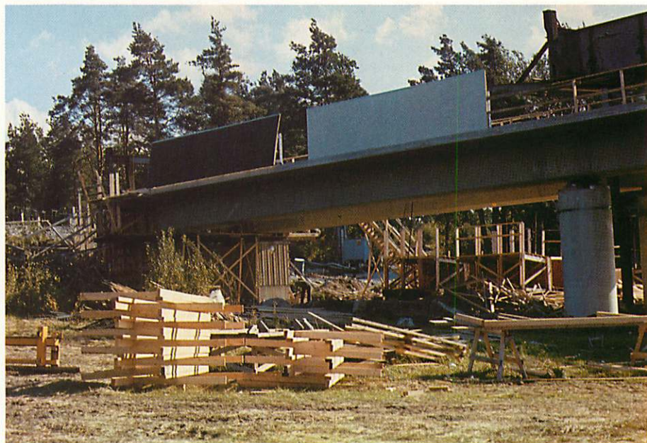
Bullerskydd på Kistaviadukten
