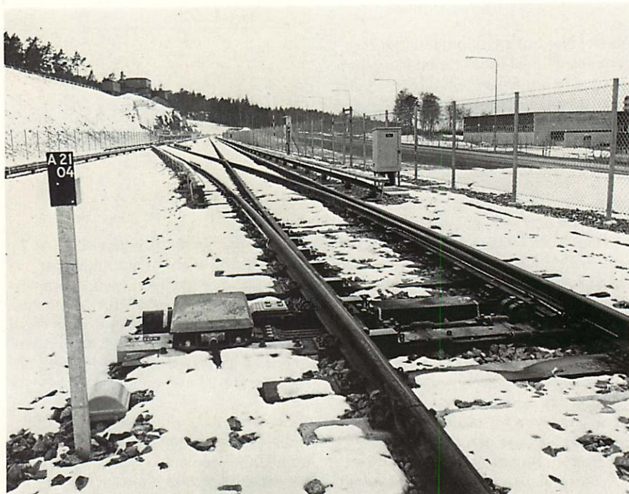
Växel med växelomläggningsdon
