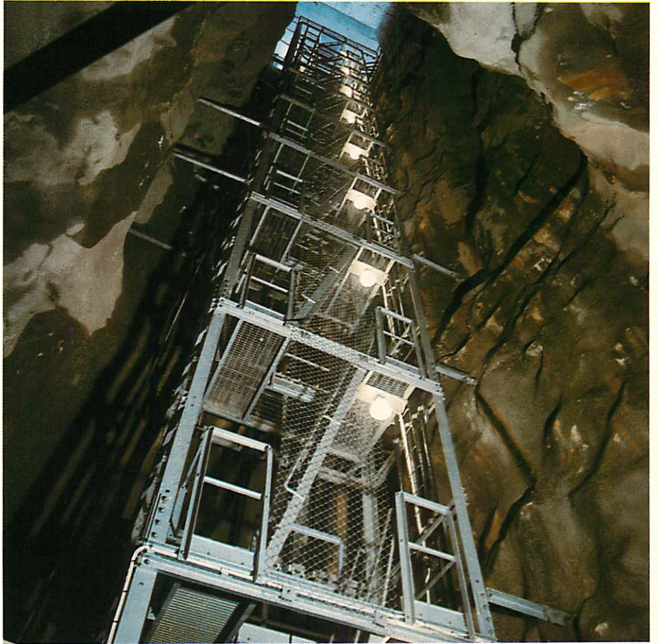
Kabelschakt mellan likriktarstation och bana
