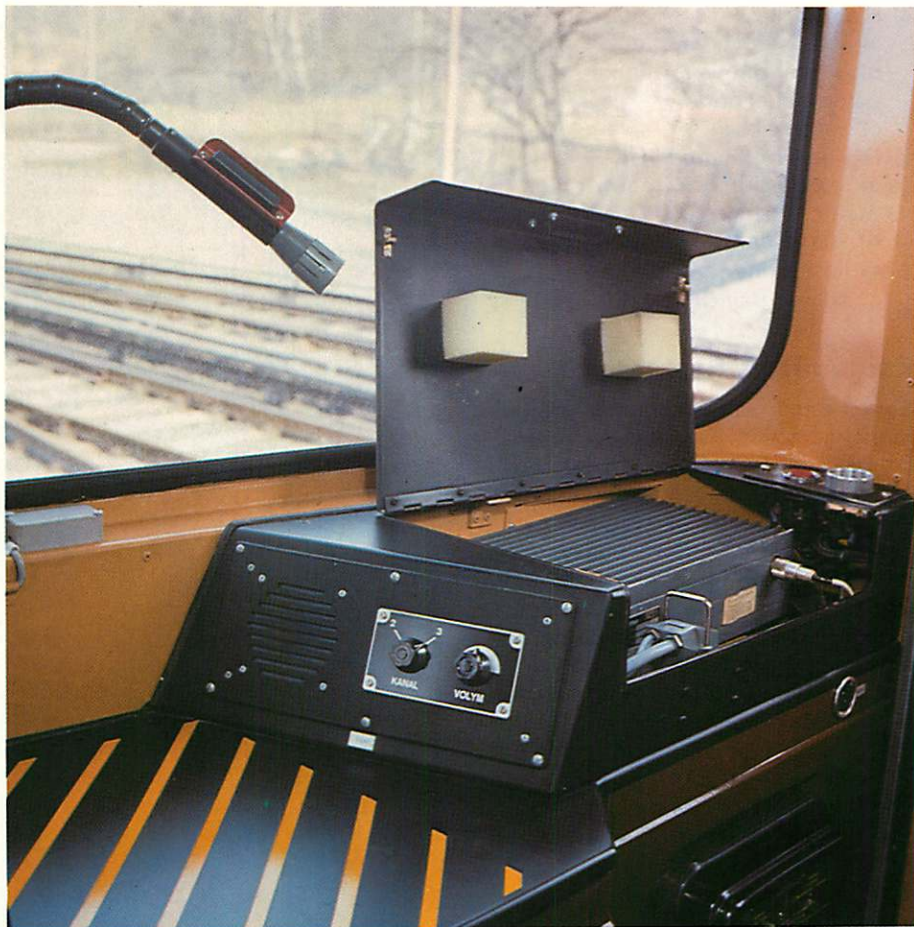
Radioutrustning i tunnelvagn typ C8
